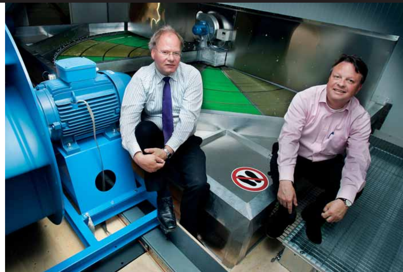
Arjan Bakker van Control Techniques (links) en Mees Lodder van KyotoCooling in een koelruimte met achter hen het warmtewiel. Foto: Maarten Hartman
